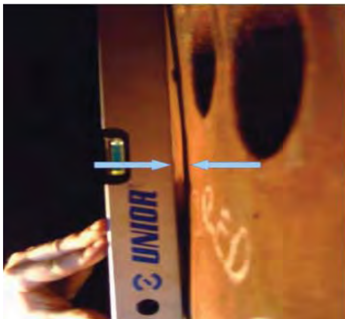
Slika 4. Deformacija cevnog zida
