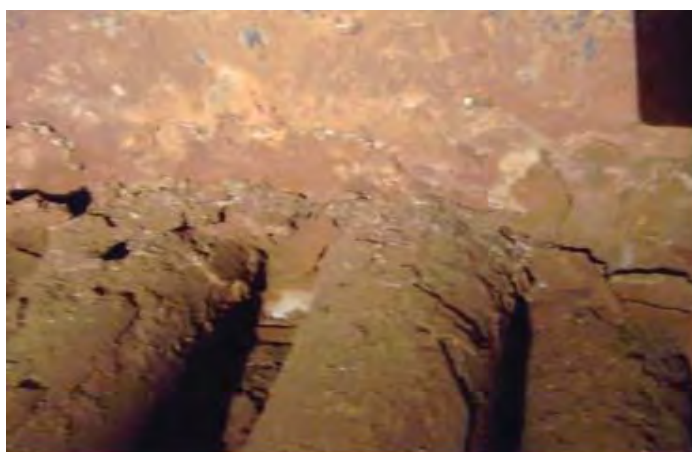
Slika 2. Naslage kamenca na spojevima dimnih cevi i cevne ploče skretne komore
